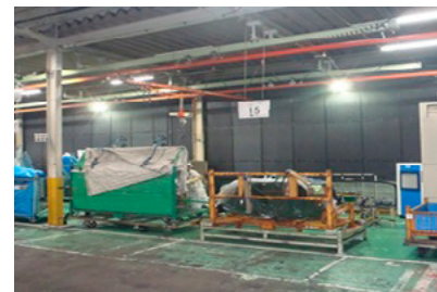
建屋内壁に設置した防音シート
