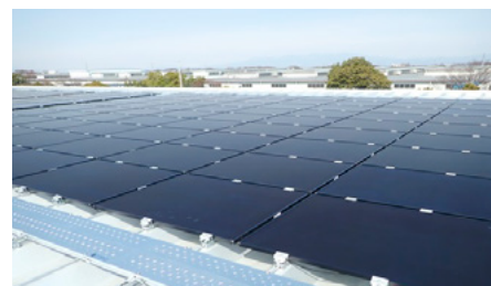
新田工場の太陽光パネル 出力約160kW
