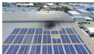
工場屋上に設置した太陽光発電パネル
