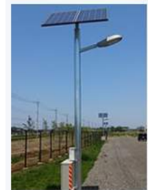
古河工場の太陽光パネル 出力2.1kW
