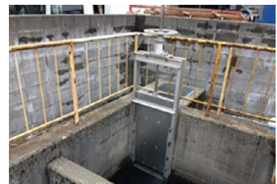
異常排水流出防止用遮断堰
