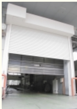
二重シャッターで防音された 専用ピット
